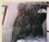
Schimmel als Folge von Bauschäden gefährdet die Gesundheit
